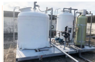
雨水回收系統設備
